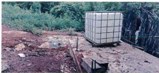
Photo n°21 : citerne de récupération des eaux pluviales
