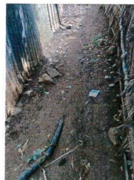
Photo n°24 : tuyau d'évacuation d'eaux usées
