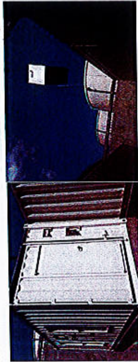
Figure 11 : Containers TESLA accueillant les batteries de stockage (1) (Source : Rapport de présentation du projet d'ALBIONIA, Décembre 2019)
