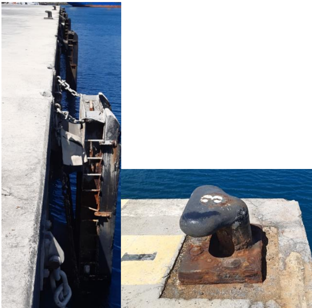
Figure 7: Photographies des équipements du Quai 1 (inspection visuelle SAFEGE – Août 2020)
