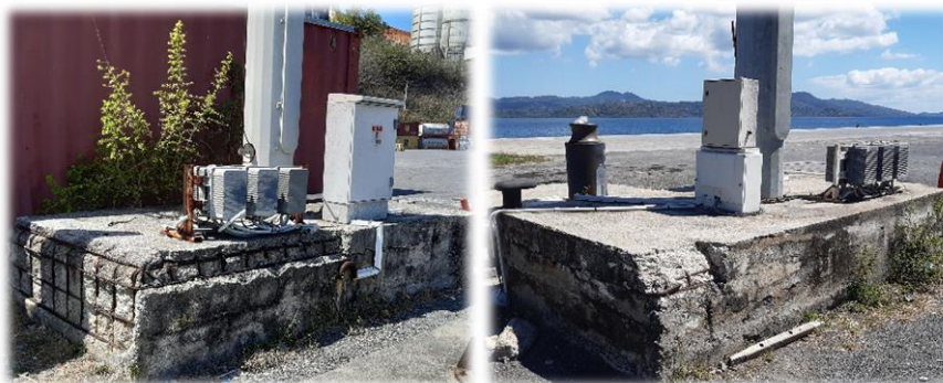
Figure 16: Photo des massifs des mâts d'éclairage
