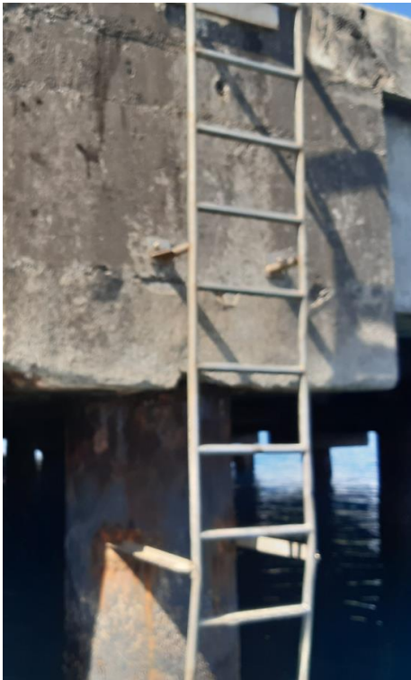
Figure 25: Photo d'illustration d'une échelle de quai
