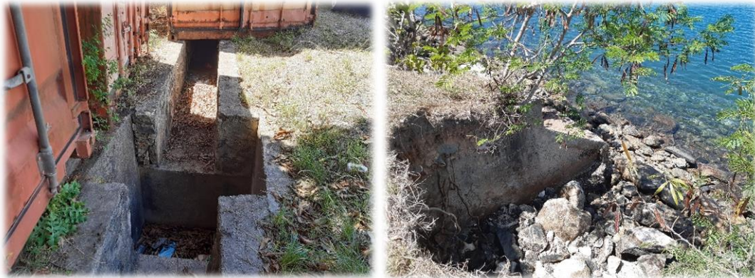
Figure 12 : Exutoire du caniveau de collecte longitudinal (route d'accès au quai)
