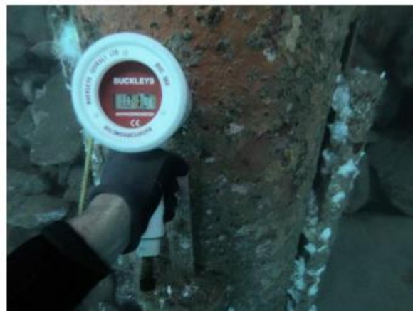
Figure 8: Mesures d'épaisseur des anodes sacrificielles sur les pieux
