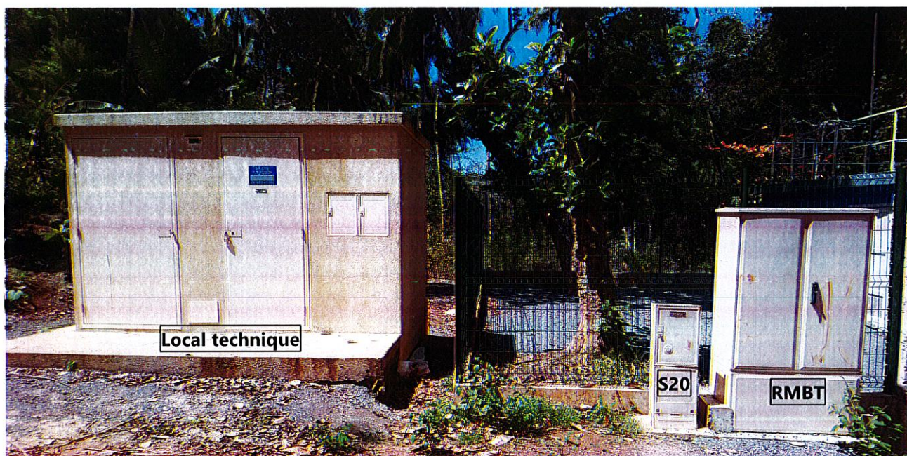
FIGURE 5 : PRISE DE VUE DU POSTE ELECTRIQUE ASSOCIE AU FORAGE (EGIS EAU, 2018)
